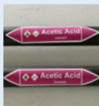
Marquage de tuyauterie
