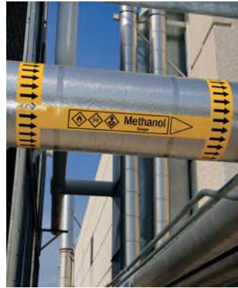
Marquage de tuyauteries
