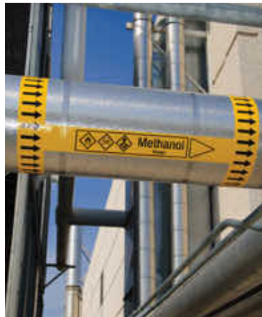
Marquage de tuyauteries
