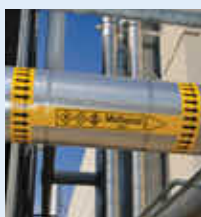
Marqueurs de tuyauteries
