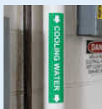
Marquage de tuyauterie
