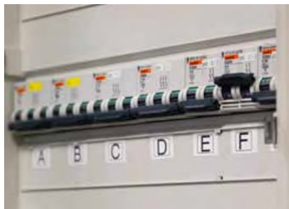
Marquage des disjoncteurs
