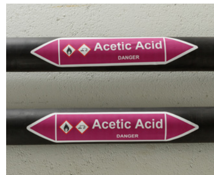
Marquage de tuyauterie
